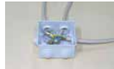
Cablee dentro de la caja de conexiones
