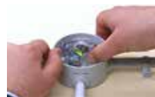
Cubra las conexiones, presionando atención no dejar áreas de vacío entre los contactos
